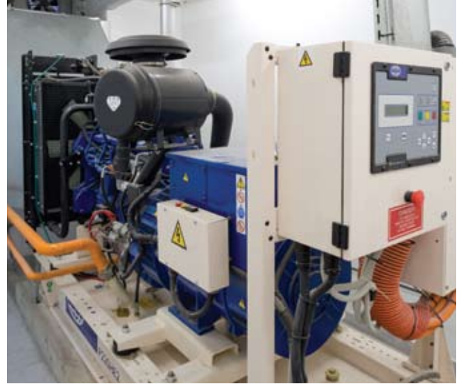
U podrumu je instaliran agregat
