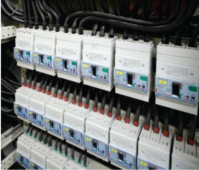
Instalirane su nove razvodne ploče
